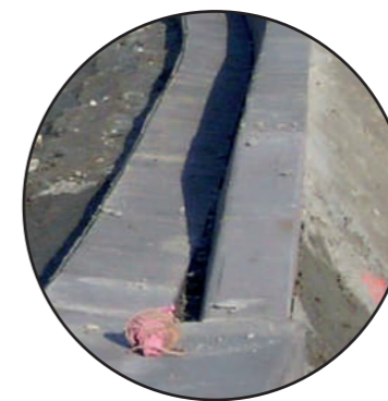
Bordure et caniveau béton
